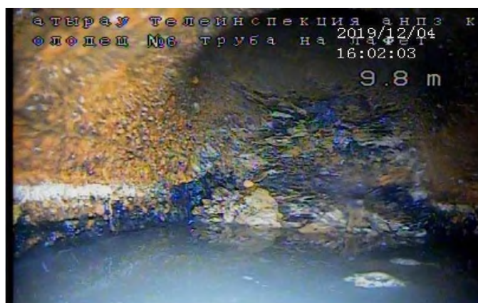
Сурет 1 – Шөгінділер мен коррозиямен құбырдың ішкі бетінің кимасы.
